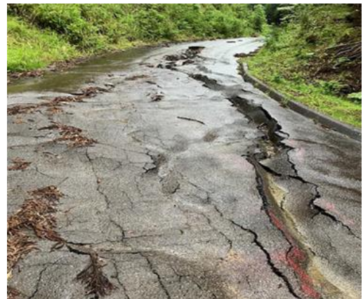
林道箱淵線 被災状況
